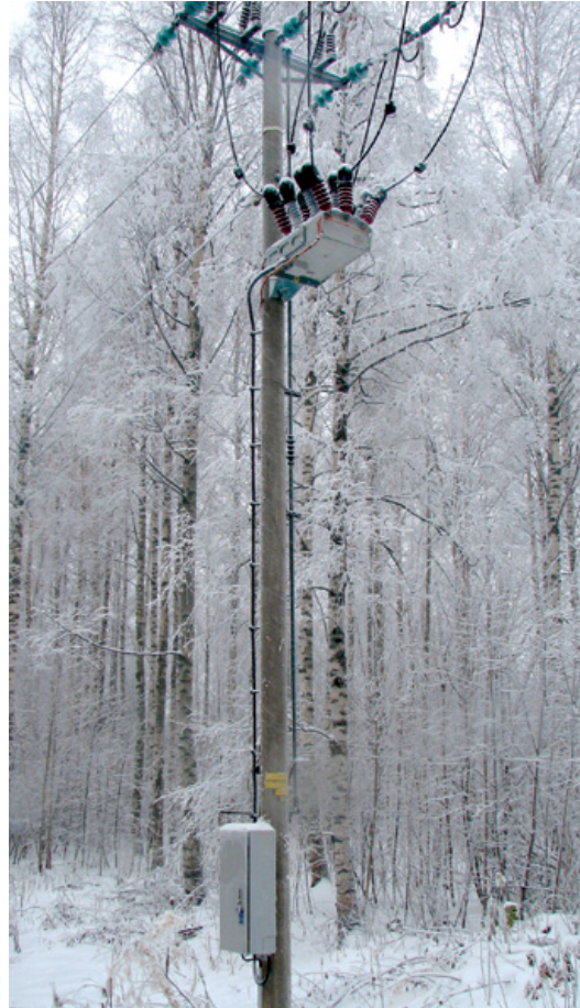
Reconector OSM y cubículo de control y comunicaciones RC
