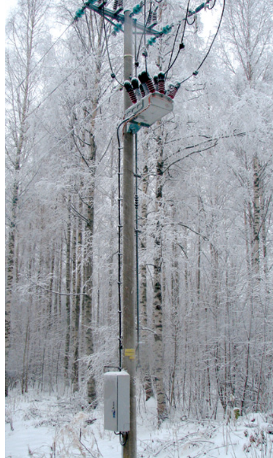
Reconector OSM y cubículo de control y comunicaciones RC
